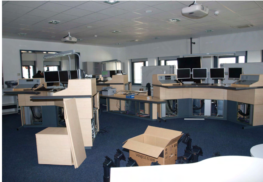
Installation der Leitstellentechnik im März 2011
