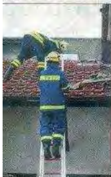
In Ahausen sicherte das THW ein beschädigtes Dach.
